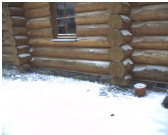
Obr. 3 Kritická oblast srubové stavby fotoIR20100211_1477.jpg
