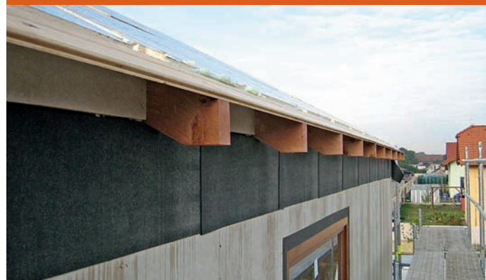
9 – Nosné krokve jsou ukončeny v úrovni stěny (nahore) a parotěsnicí vrstva z asfaltového pásu je přetažena na obvodovou stěnu (dole)
