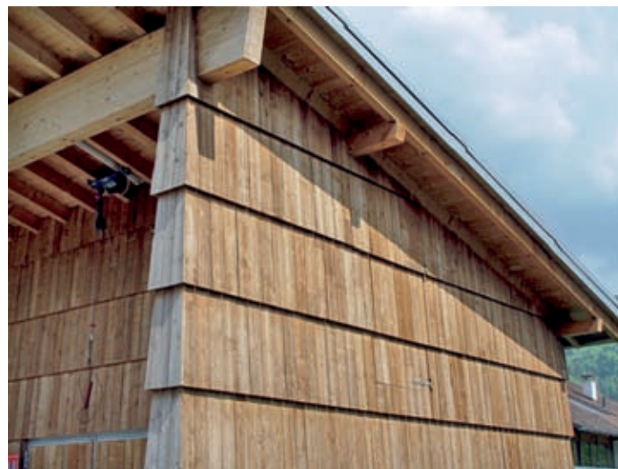
Napůl obložení prkny, napůl šindelem – typická fasáda kutíla. Prkna i šindele jsou snadno k dostání a celková pracnost není o nic větší než u fasád z prken
