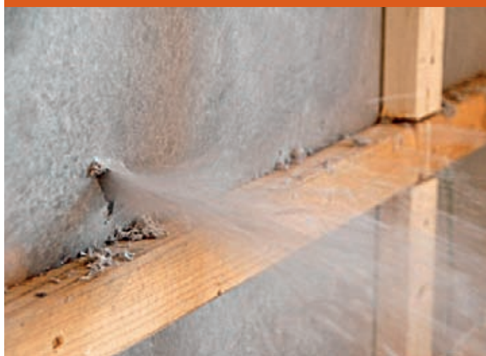
5 – Kontrola spojitosti parotěsnicí vrstvy při aplikaci foukané izolace, netěsnost se projeví vylétáváním materiálu z otvoru (dole)
