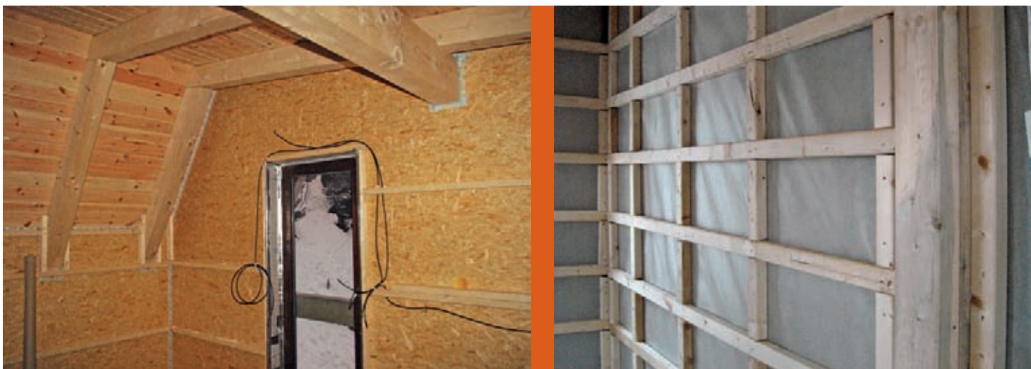
3 – Parotěsnicí vrstva z desek OSB (vlevo) a z fólie lehkého typu (vpravo) s obousměrným roštem vymezující ochrannou vzduchovou vrstvu
