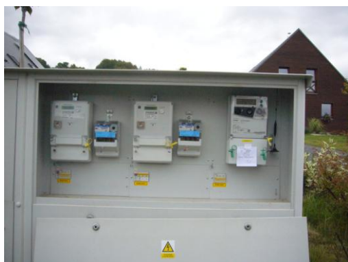
Obr. – měření spotřeby el. energie na patě domu
