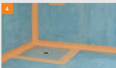
Po položení, slepení a sešroubování podlahových prvků Powerpanel TE jsou plochy natřeny základním nátěrem fermacell a v oblastech napojení umístěn těsnicí systém
